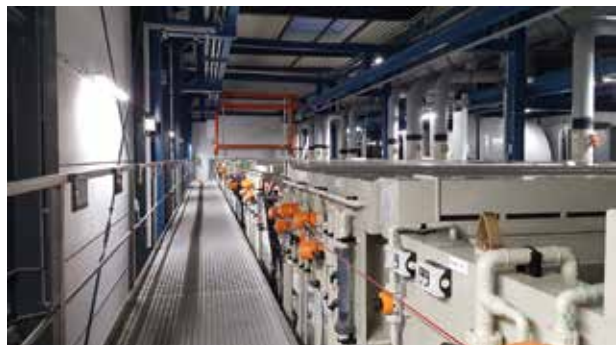
Oberflächenveredelung: MKV Ni-Sulfamat Anlage im Werk der AHC Benelux in Venlo/Benelux
