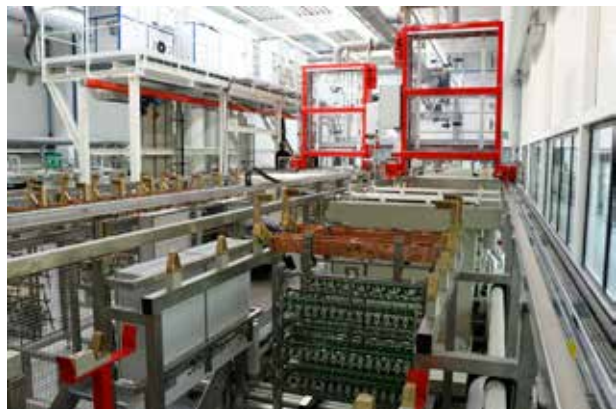
Elektropolieranlage der Firma GEMÜ Gebr. Müller Apparatebau GmbH & Co. in der Aufbauphase, Standort Kupferzell/ Deutschland
