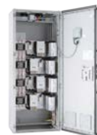
Blindstrom- kompensations- anlagen
